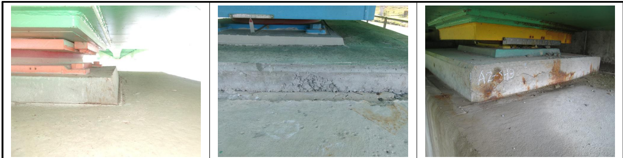
① 교량받침 균열(0.3mm이상), 단면손상 - 진전 여부확인
